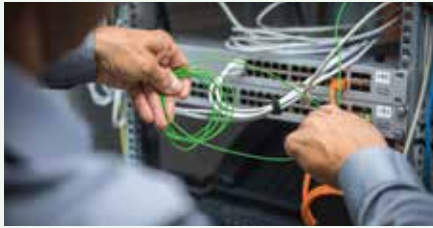
Schule Münchwilen ist vollständig mit Breitband-Internet via Glasfaser (grünes Kabel) erschlossen.
